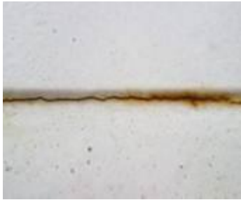
↑ 3.12 irudia. Korrosioa arteketan.
