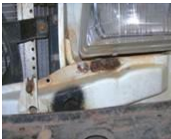
↑ 3.14 irudia. Soldadurak eragindako korrosioa.
