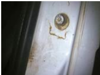
↑ 3.13 irudia. Nekeak eragindako korrosioa.
