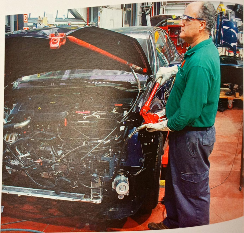
Aplicación de un equipo de tracción en la recuperación de un capó
