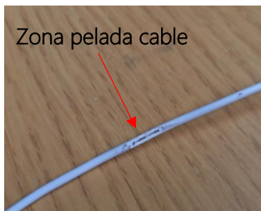
Ilustración 8: Ejemplo cable en mal estado
